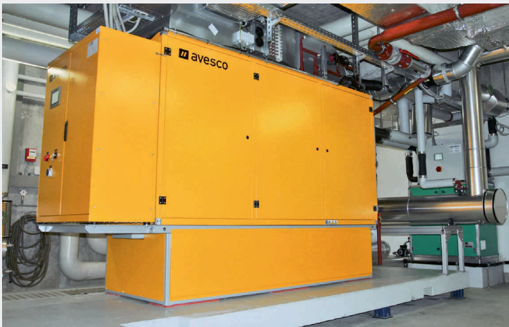
Fig. 2 Bei der Erneuerung der Energieversorgung des Alterszentrums Alban-Breite in Basel wurde auf das Contracting und die Eigenstromnutzung gesetzt.
