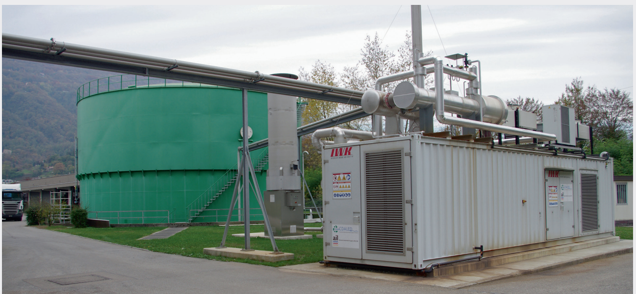
Fig. 3 Das Klärgas der Abwasserreinigungsanlage von Lugano wird mit einem Blockheizkraftwerk zur Wärme- und Stromproduktion genutzt.
